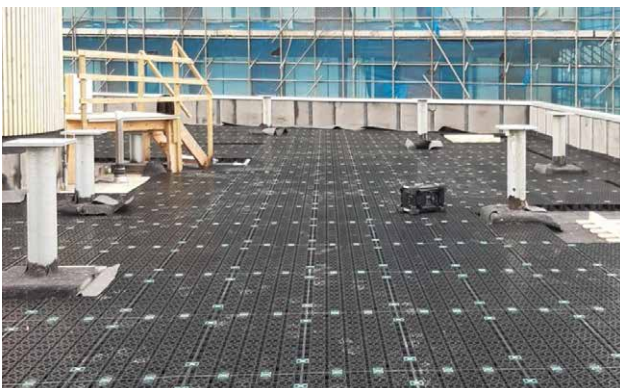
^ Retentiekragen en de stalen voeten van de loopbrug zijn geplaatst. ((Foto: De Enk Groen & Golf)
