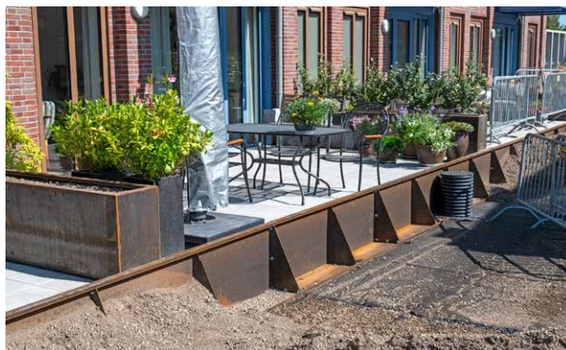
^ Cortenstalen keerwanden sluiten zowel de tegels op als het substraat van de tuinen. (Foto: Zoontjens)
