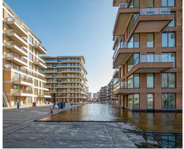
^ Een sectie van de daktuin wordt op waterdichtheid getest. (Foto: Koopmans Bouw)
